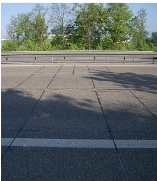
Abb.: Dauerzählstelle – Erfassung der Kfz mittels Induktionsschleifen
